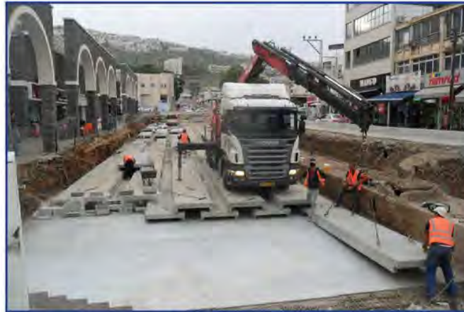
בעת עבודות הנחת כיפין על גבי כיפין בטבריה באחד הקטעים שהוכשר לכהנים
